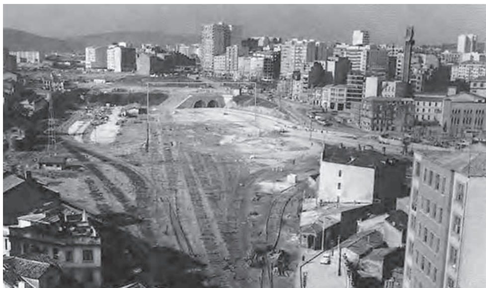
Fig. 66: Desmantelamiento de vías de la estación de Norte y túneles de Avda. Salgado Torres. Fuente: archivo La Voz de Galicia
